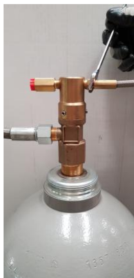
Fotografía de colocación de latiguillo de pilotaje de \frac{1}{4} " de la válvula.
